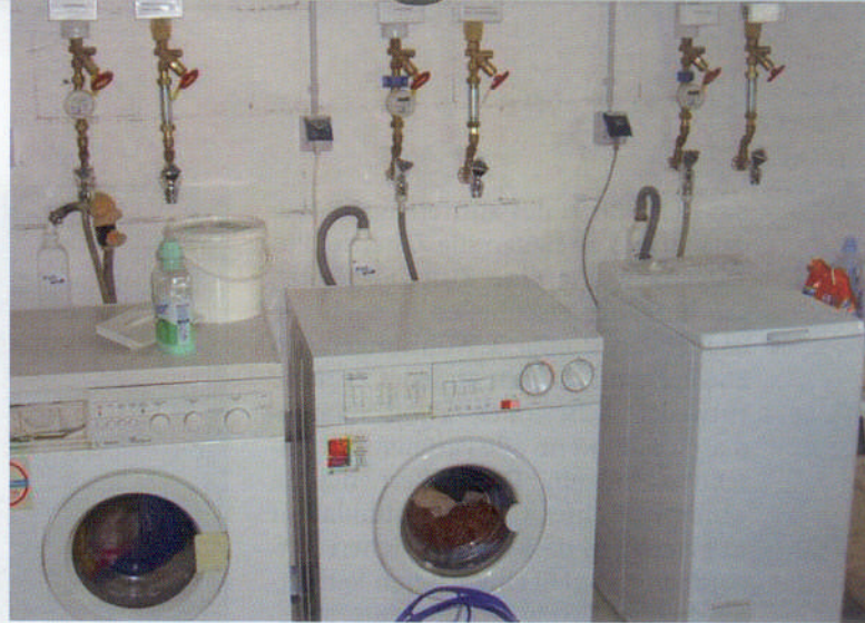
Die Waschmaschinen im Kellergeschoss des ersten Bauabschnitts verfügen sowohl über einen Trink- als auch einen Regenwasseranschluss.
